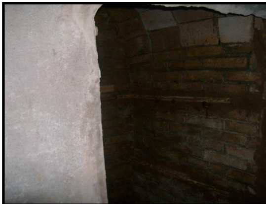
Sala de l'electricitat
